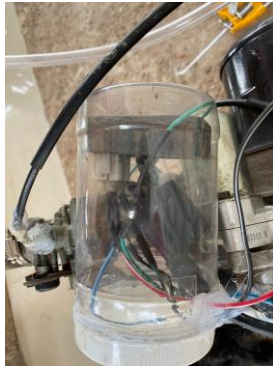
Hình 5. Hệ thống điện chống nước
